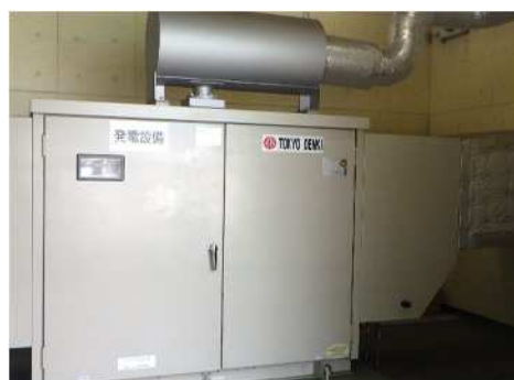
自家発電設備
