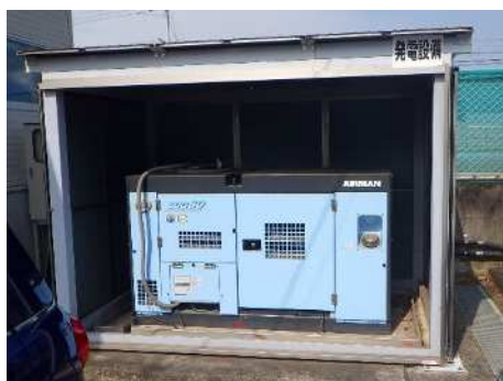
自家発電設備
