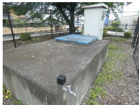
取水ポンプピット
