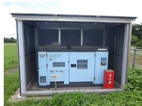
自家発電設備
