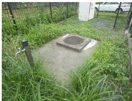
取水ポンプピット
