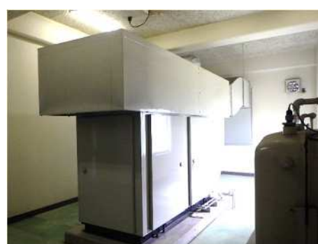
自家発電設備
