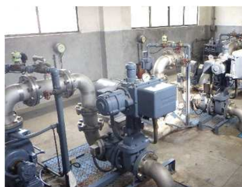
機械設備（配水ポンプ）
