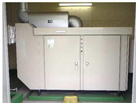
自家発電設備
