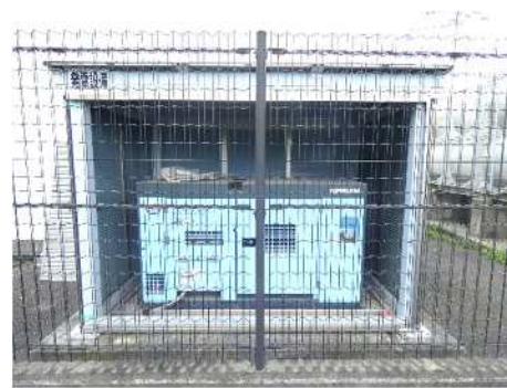
自家発電設備
