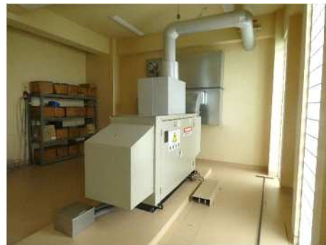
自家発電設備
