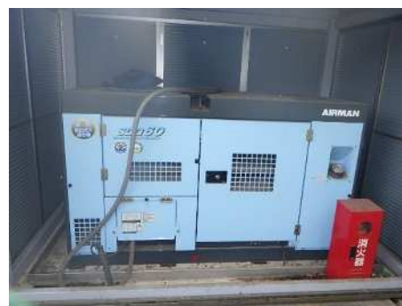
自家発電設備
