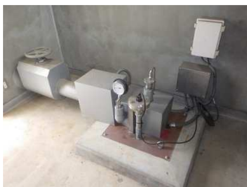
機械設備（取水ポンプ）
