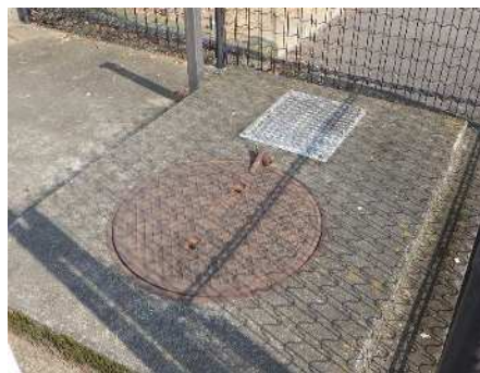
取水ポンプピット
