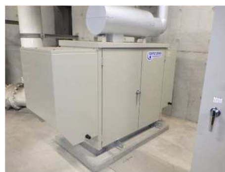
自家発電設備
