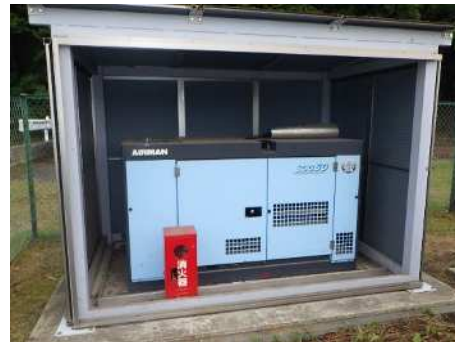
自家発電設備
