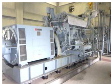
自家発電設備
