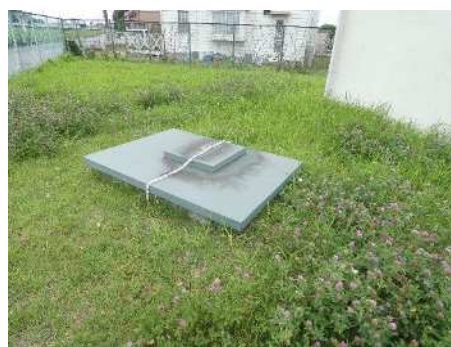
取水ポンプピット
