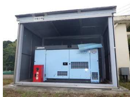
自家発電設備
