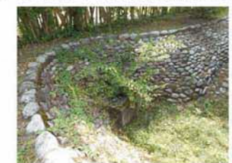
⑦ 排水樹に植物が繁茂状態の調整池
