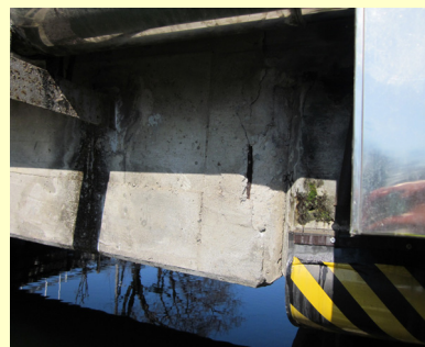
コンクリート桁の鉄筋の露出
