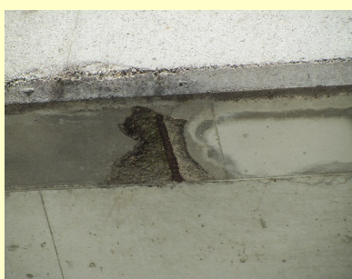
地覆（下面）の鉄筋の露出
