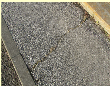
舗装のひびわれ
