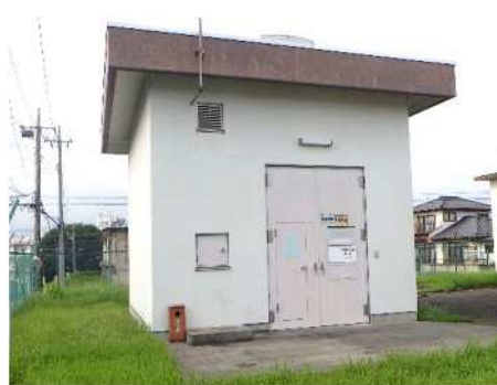
自家発電設備
