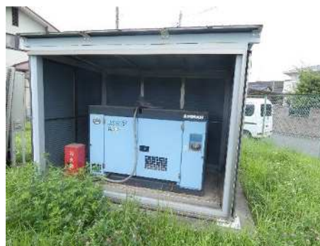
自家発電設備
