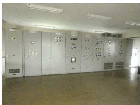
電気設備（制御盤）
