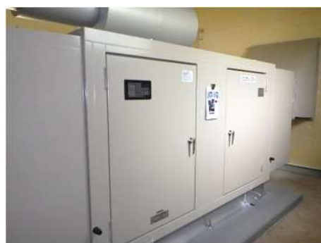
自家発電設備
