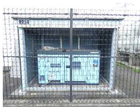
自家発電設備
