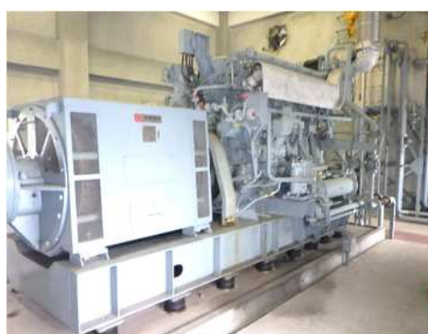
電気設備（自家発電機）
