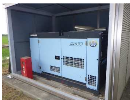
自家発電設備
