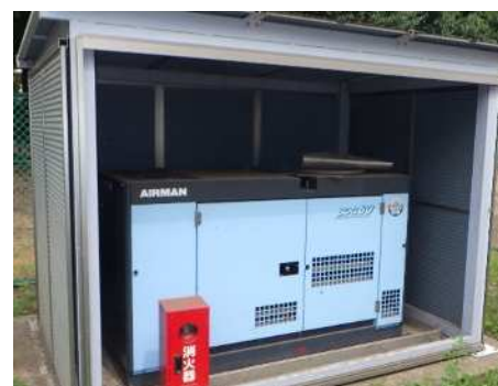
自家発電設備
