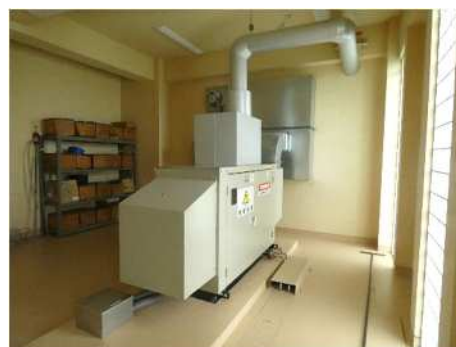
自家発電設備
