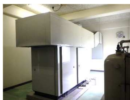
自家発電設備
