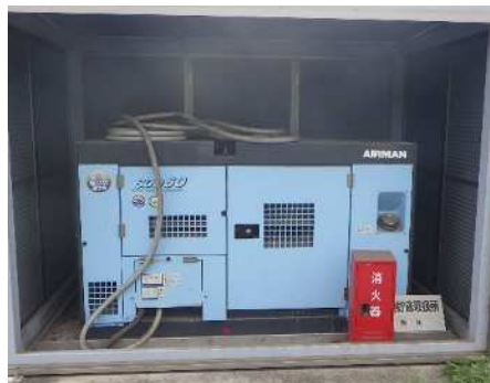
自家発電設備
