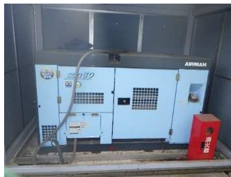
自家発電設備
