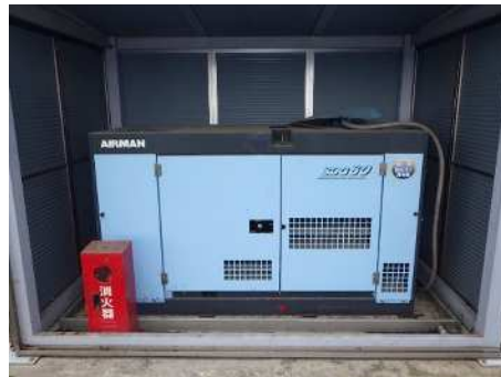
自家発電設備
