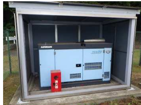
自家発電設備
