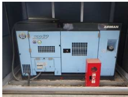
自家発電設備
