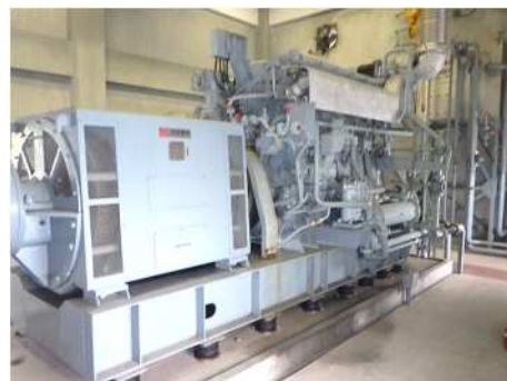
自家発電設備
