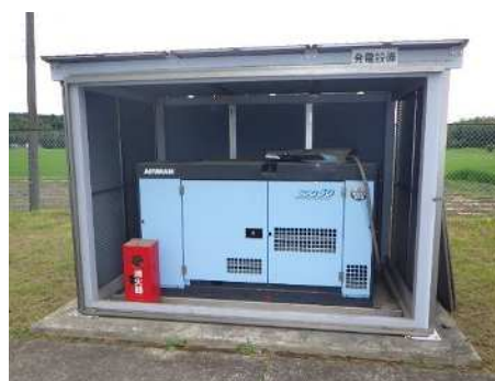
自家発電設備
