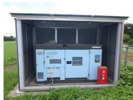
自家発電設備
