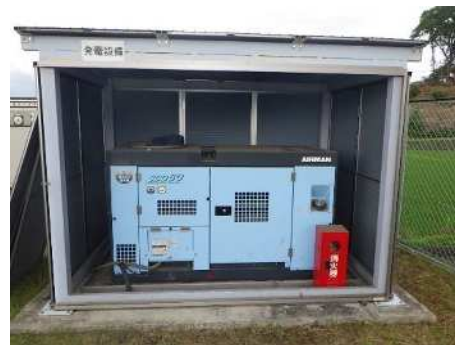
自家発電設備
