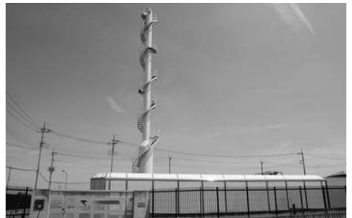
東京ガスのガバナステーション(長田地内)
